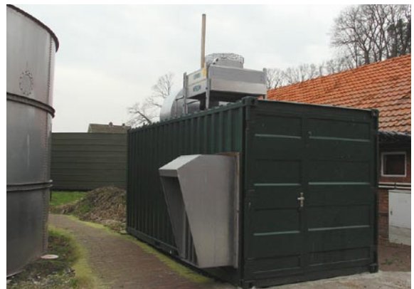
Maschinenhaus der Anlage Holtmann
