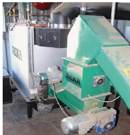
Die Feuerungsanlage der Heuverbrennungsanlage ist weitgehend automatisiert und wird nach Bedarf selbsttätig mit Brennstoff beschickt. (Quelle: H. Oechsner)
