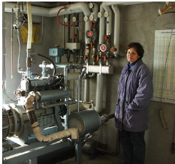
Frau Heubuch im Maschinenhaus der Biogasanlage.
